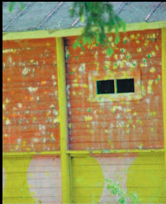
🚩 Стена дома после трехминутной перестрелки.
